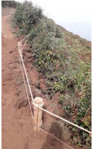
Effondrement du sentier côtier
