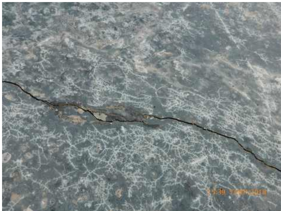
Fissure sur un fond de fosse, résultant d'un colmatage du système de drains sous la fosse
